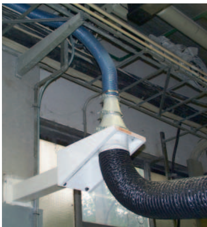
Falsche Auslegung der Rohrleitungen: Verkleinerung des Strömungsquerschnitts in Absaugrichtung
