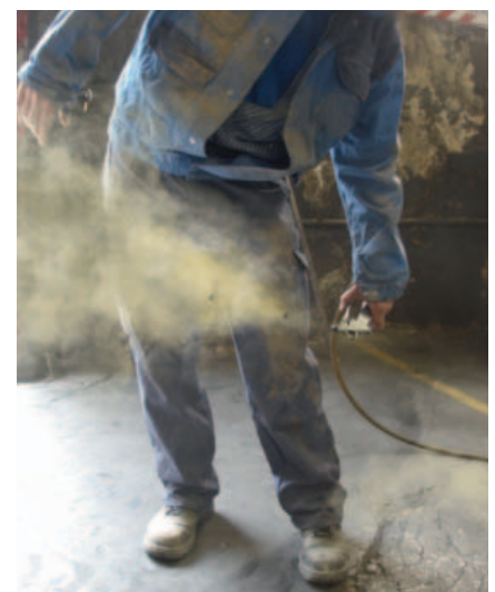
Verbotenes Abblasen mit Hilfe von Druckluft
